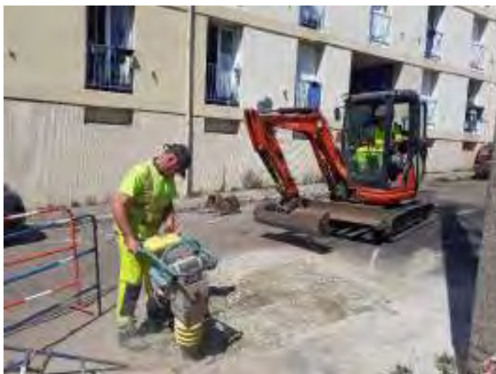
Figure 43 : Remise à niveau de la voirie à la suite d'un affaissement de chaussée (suspicion de casse)
